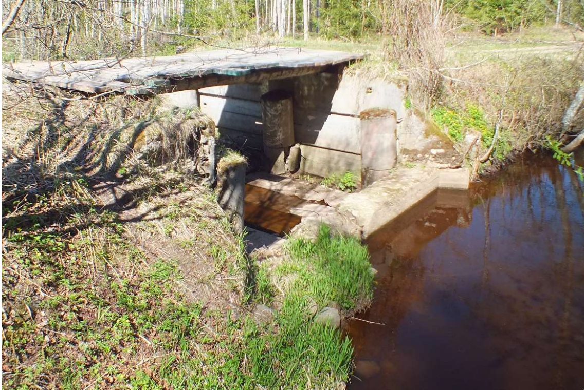
Foto 3. Regulaator. Vee vool Ura jõkke toimub ainult amortiseerunud konstruktsioonide lekkimise tõttu.
