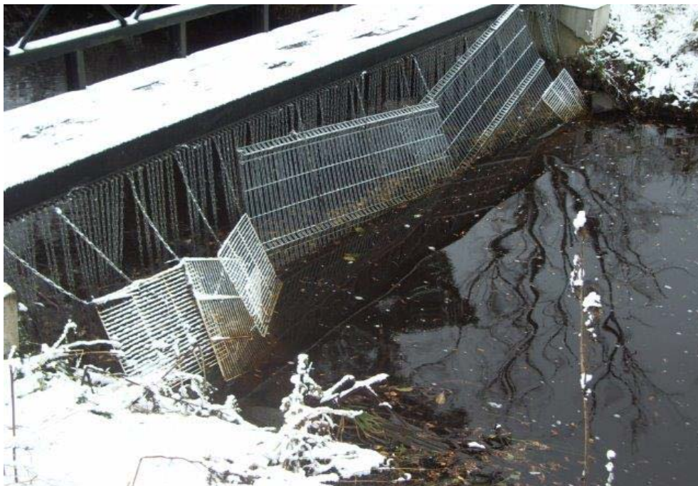
Foto 15. Kalade hüdroelektrijaama väljavoolukanalisse sattumise vältimiseks on lisaks kettidest kardinale paigaldatud ka käepärased metallrestid (26.10.17).
