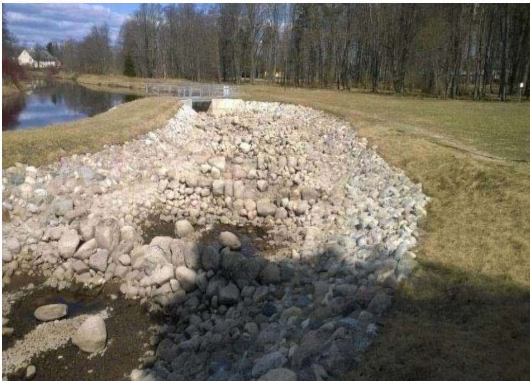
Foto 37. Kevadel oli Puurmani kalapääs kuival paisu purunemise tõttu (19.04.2017).
