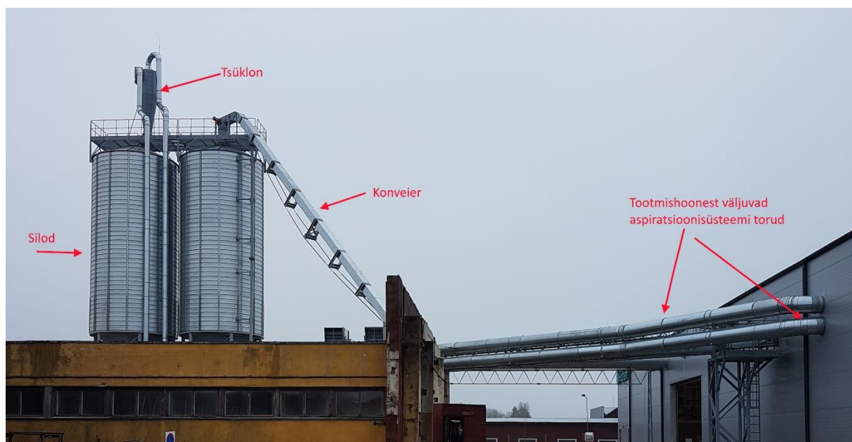
Joonis 3. Saepuru ja puidujäätmete kogumissüsteem suures tootmises.
